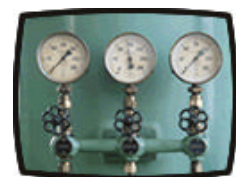
Instalazio hidroelektrikoaren neurtzaile batzuk
