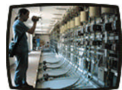
Grabando los repartidores de energía hidroeléctrica
